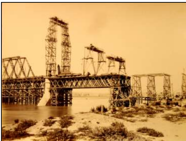
Fig.12. Execuția primei grinzi cu zăbrele în consolă, dinspre Cernavodă. Sistemul de schele este susținut de un grup de piloți de lemn introduși sub cota fundului albiei fluviului. Se lucrează la montajul tablierului.
